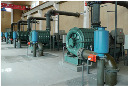
上海南汇污水处理厂
